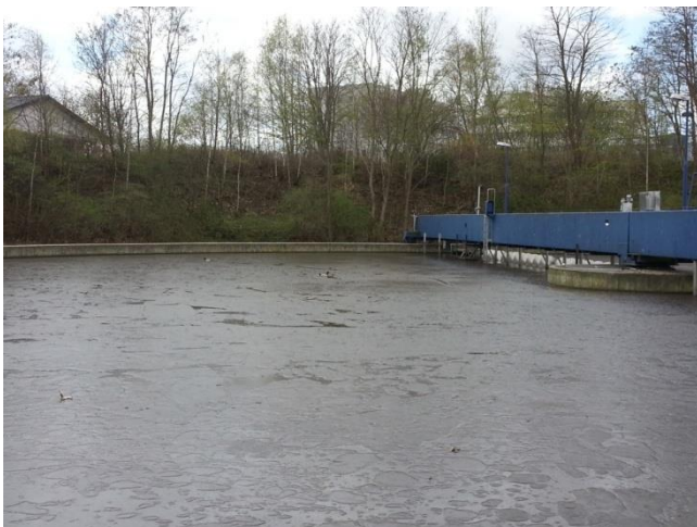
Nachklärung (Absetzbecken für Klärschlamm)
