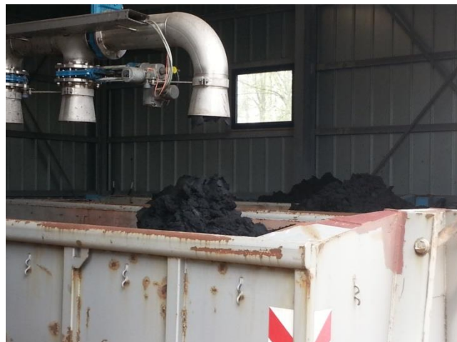
Klärschlamm-Sammlung für die Entsorgung
